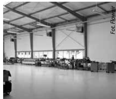
Fot. 4. Najlepsza dystrybucja powietrza zapewniona jest gdy nagrzewnica zostanie naściennie zamontowana na wysokości 2,5 ÷ 5m
